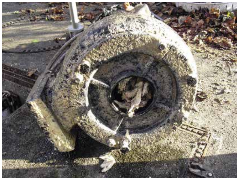
Durch Feuchttücher verstopfte Saugseite der Pumpe bei Affalterbach
