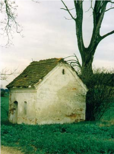
Die Kapelle in schlechtem Zustand vor der Renovierung (2000)
