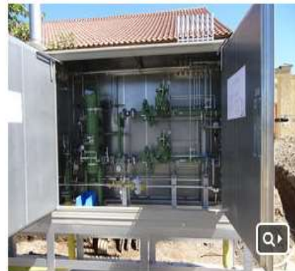
Eine zweiseitige Gas-Druckregel- und Messanlage (GDRM-Anlage) im Aluminiumschrank
